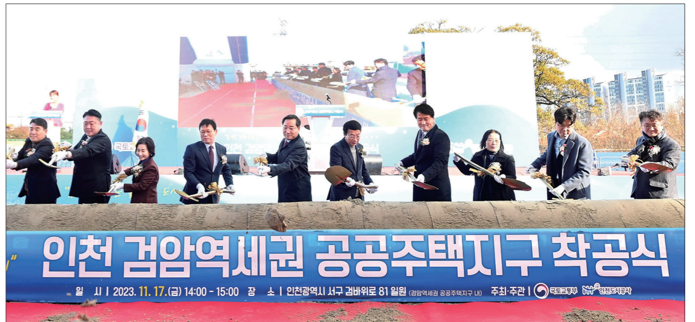
'검암역세권 공공주택지구' 첫 삽 최근 인천 서구 검암동에서 열린 '검암역세권 공공주택지구 착공식'에서 유정복 인천시장과 조동암 인천도시공사 사장, 강범석 서구청장 등이 시삽을 하고 있다. 인천시 제공
